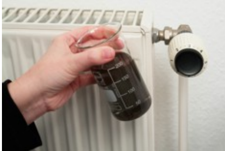
Unbehandeltes Heizungswasser mit unerwünschtem Magnetitschlamm
